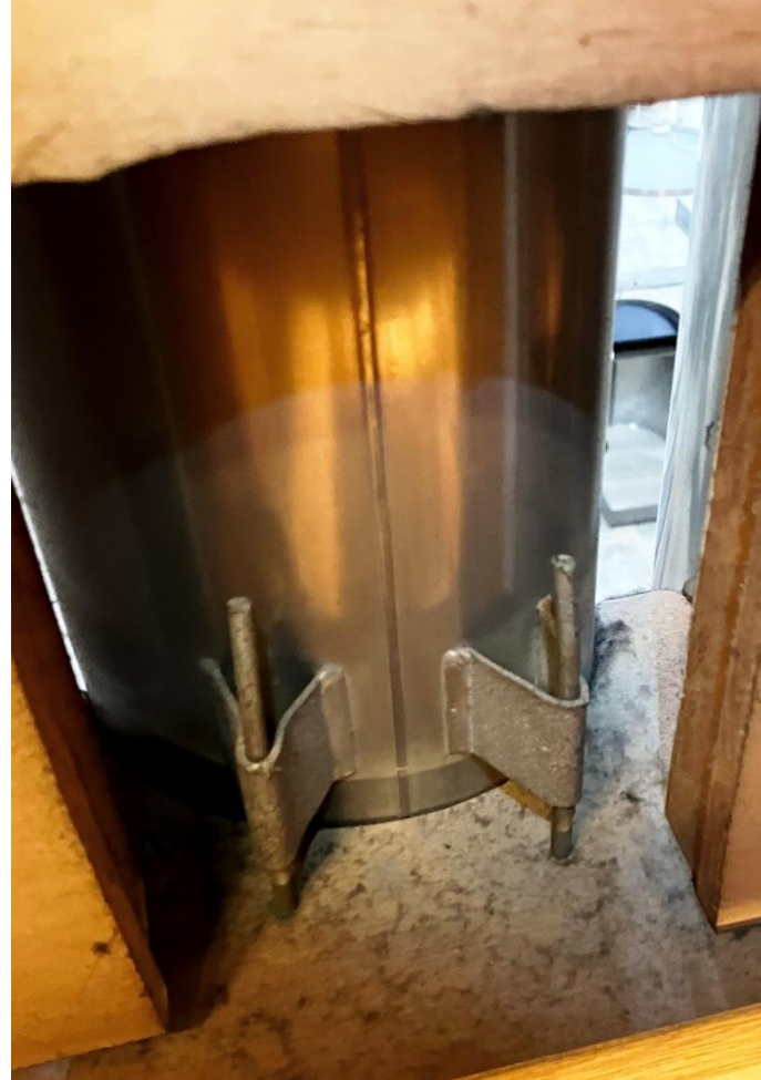
Nicht ausreichend gesicherte Prospektpfeifen
