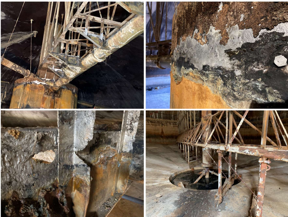
Abbildung 3 - Schadensbilder am Krählwerk ED 1
