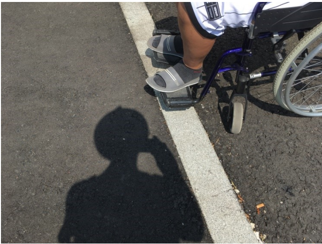
Kante am Gehweg Bodenseestr. in Freiam
