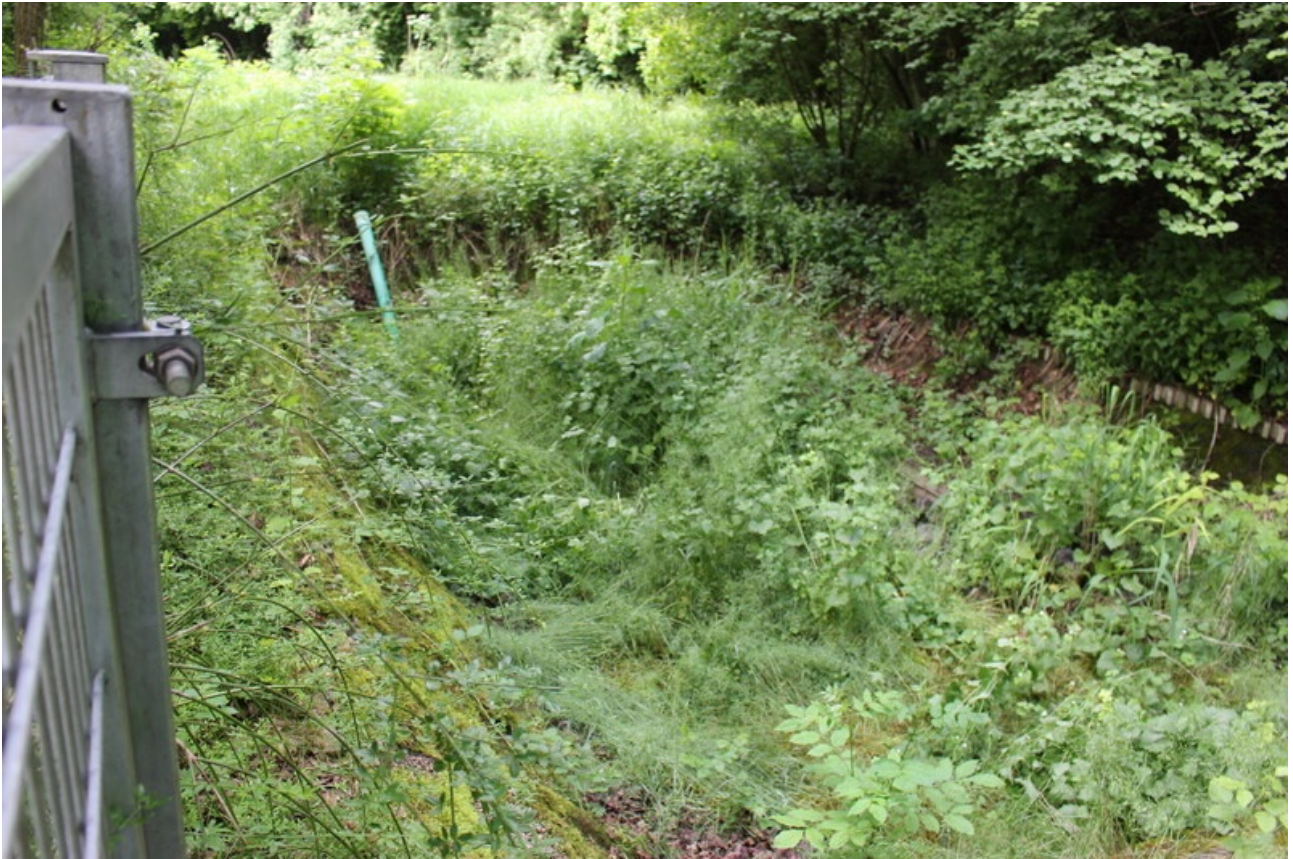
Zustand biologische Reinigungsanlage
