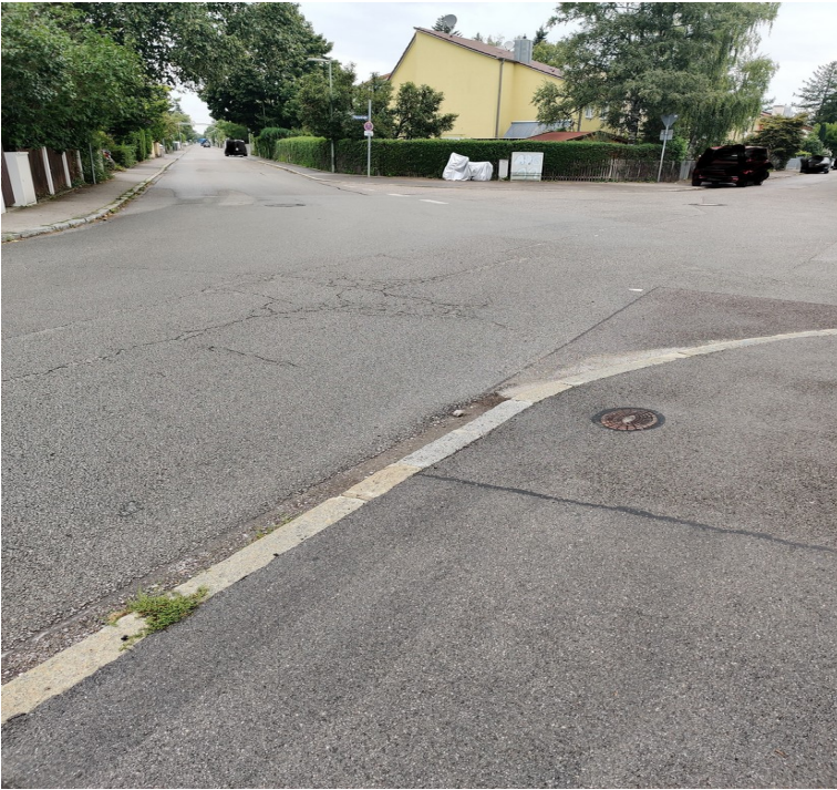
Abb. 1: Kreuzung aus der Perspektive von Poststraße-Ost in Richtung Florastr. - Die Straßenmarkierung ist völlig abgenutzt, starke Versiegelung.
