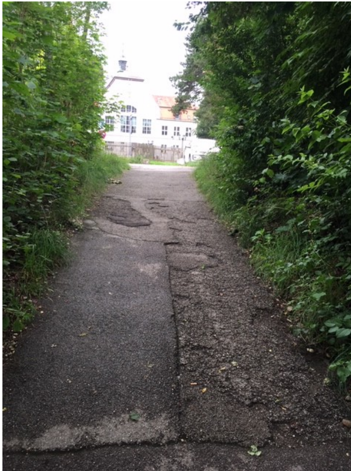
Die restlos kaputte Zufahrt zur Unterführung, gesehen von Ost nach West.
