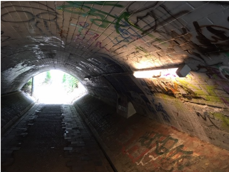
Unterführung von Ost nach West mit einziger Leuchtstoffröhre.
