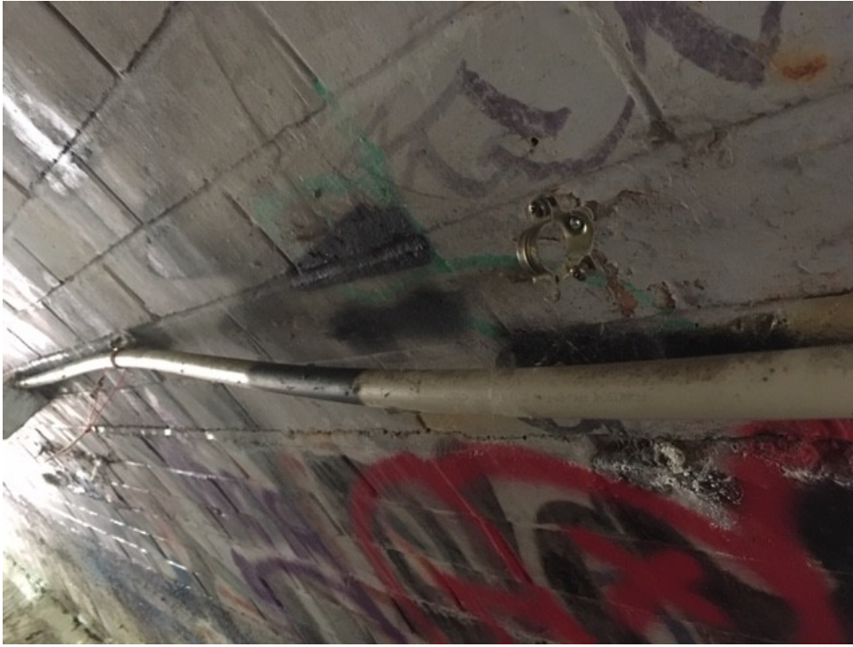
Die schadhafte Verankerung des Elektrokabels.
